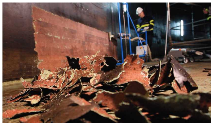
RPR工法施工で発生する塗膜廃棄物（イメージ）
