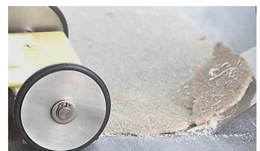
浮き上がった塗膜は簡単に除去可能に
