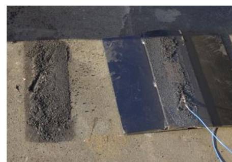
写真 2. アスファルトモルタル損傷状況
